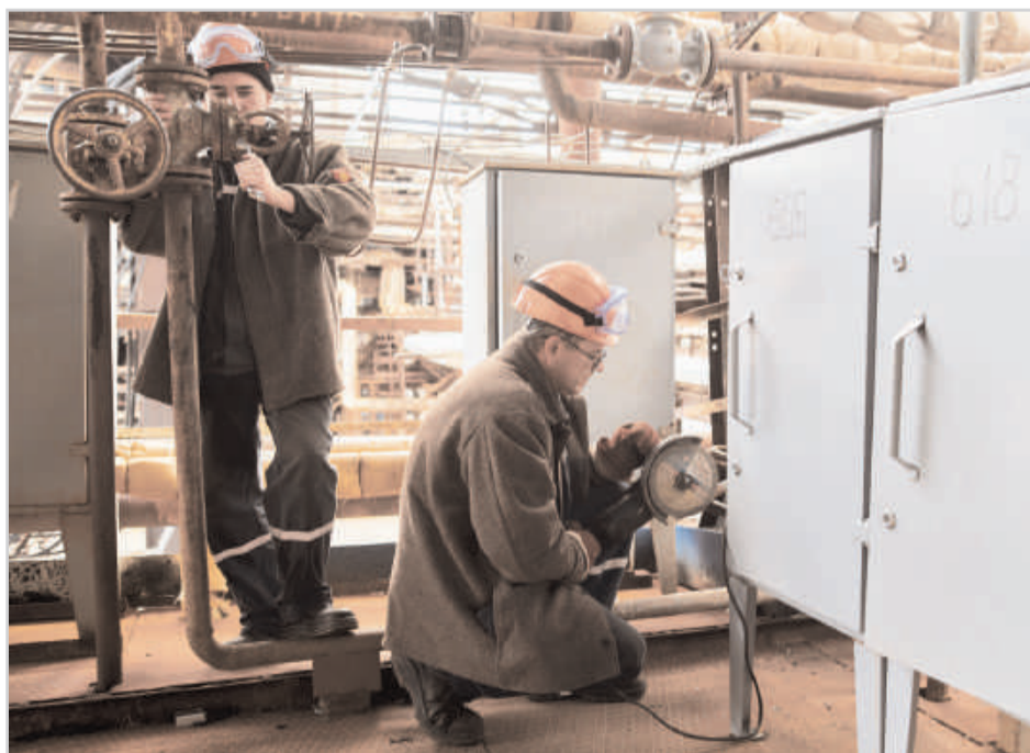
Бригада цеха РТО ООО "Химремонт" (мастер А. Осипов) производит замену ящиков КИП и монтаж линий обогрева на отметке 7 м наружной установки цеха И-4.
