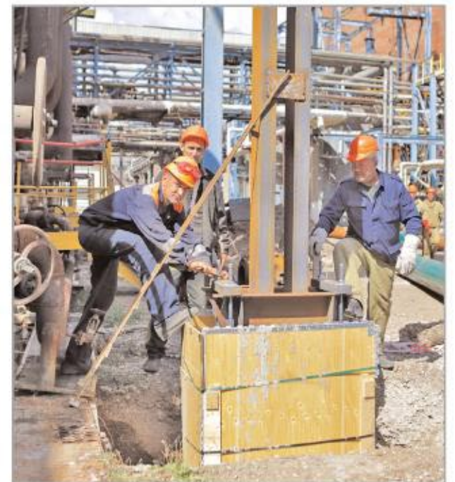
Работники ООО "Уралтехстрой" монтируют коллектор промоборотной воды на наружную установку цеха И-5в (установка опоры)
